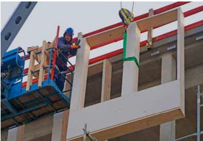
Beim Landesuntersuchungsamt in Koblenz setzt Neumayr eine hybride Fassade aus Holz und Aluminium um. Damit lassen sich für Zertifizierungen wie LEED oder BNB ökologische Punkte sammeln. Seite 6
