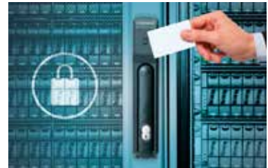
Das Sicherheitsschloss am Server erhöht die Datensicherheit gemäß DSGVO.
